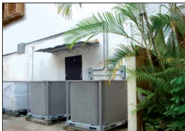
Vista de aire acondicionado de la Escuela de Inglés
