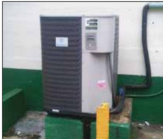
Unidad de planta de aire acondicionado de 15 toneladas.
