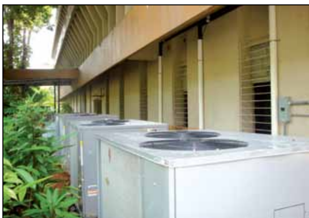
Vista de equipo de aire acondicionado.
