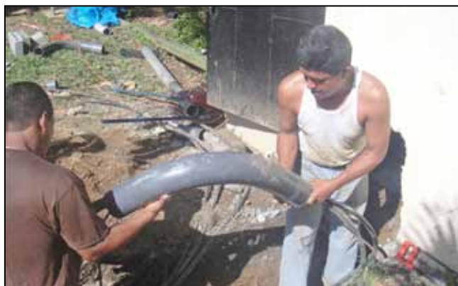
Instalación eléctrica de la planta.
